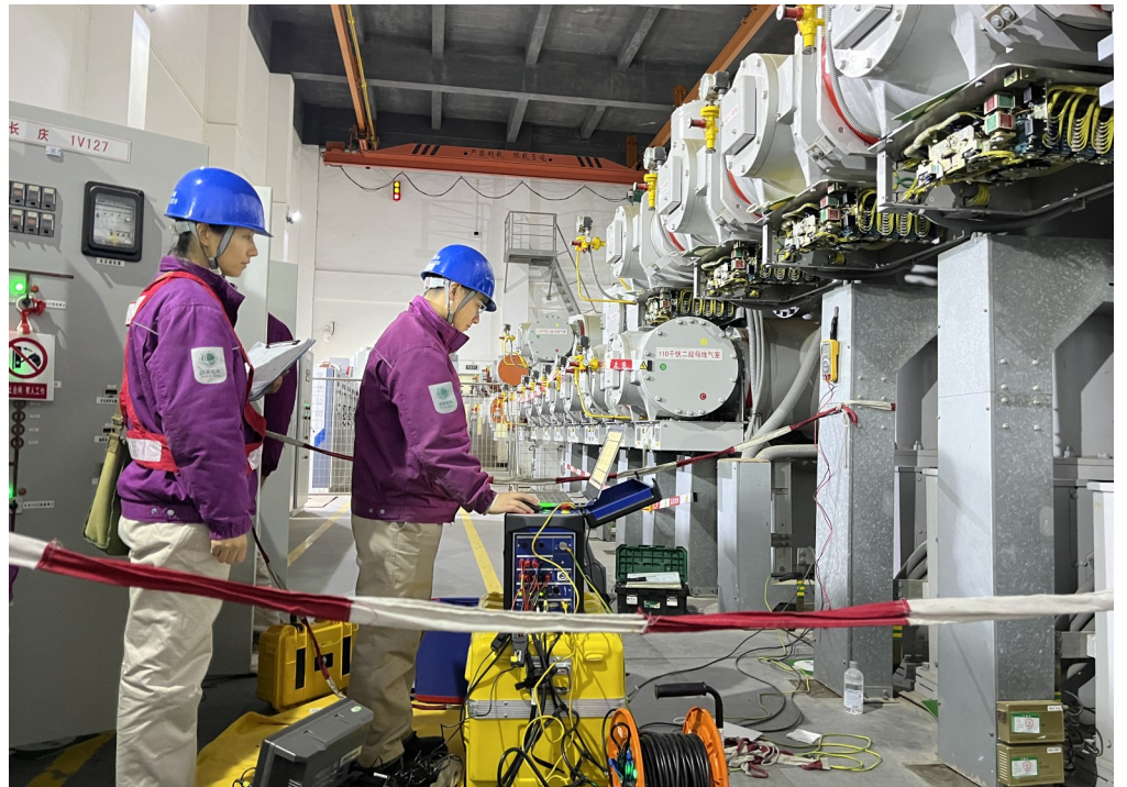
春节前,国网上海超高压公司检修人员在220千伏长兴变电站开展110千伏GIS断路器、闸刀机构检修维护工作。 国网上海市电力公司供图
