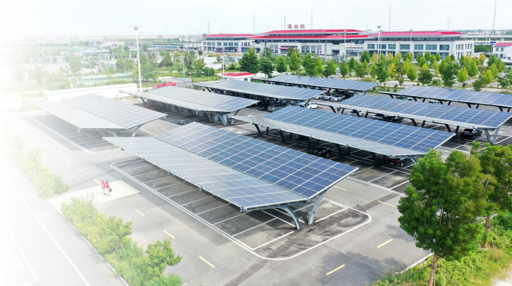
9月26日,国网连云港供电公司组织电力技术人员对灌云县高铁站“光储充”一体充电站设备进行安全巡视检查。该站共建有64个直流车位,8个交流车位,一期投运32台快充桩,充电站的顶棚由1392块光伏板构成,装机容量807.36kWp,能极大满足周边市民及游客新能源充电需求。 人民图片
