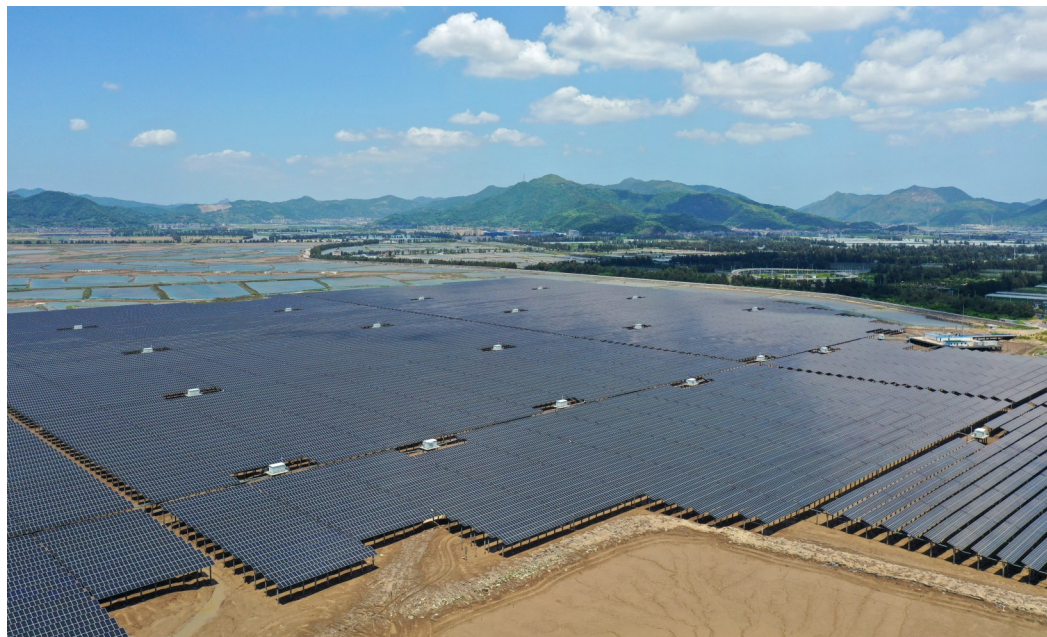
近年来，浙江省玉环市结合海岛地区土地少、资源少等实际情况，充分利用海涂资源丰富的优势，在低洼地等地带开发建设渔光互补光伏电站，加快新型电力系统建设，将清洁电能用于生活生产，推进低碳减排，助力乡村振兴、带动群众增收。图为，玉环市清港镇苔山村海涂华能130兆瓦渔光互补光伏电站。
