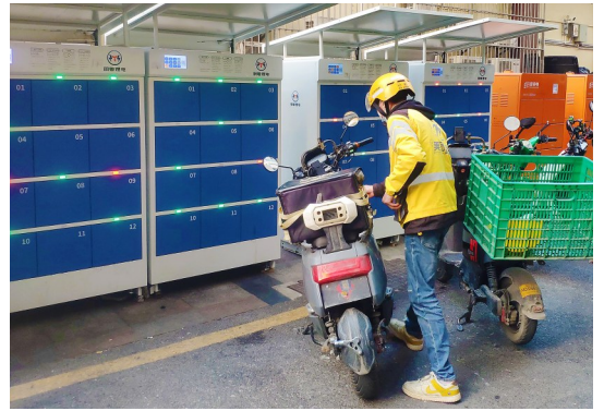
广东省深圳市街头的电动车换电站电池充电柜,一位快递员在给电动车换电池。视觉中国
