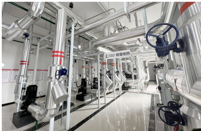
河北雄安新区科创中心中试基地智慧综合能源项目地热站内景。
