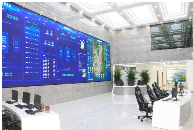
白城市镇赉县城乡智慧治理服务中心“三位一体”综合管理服务台。
