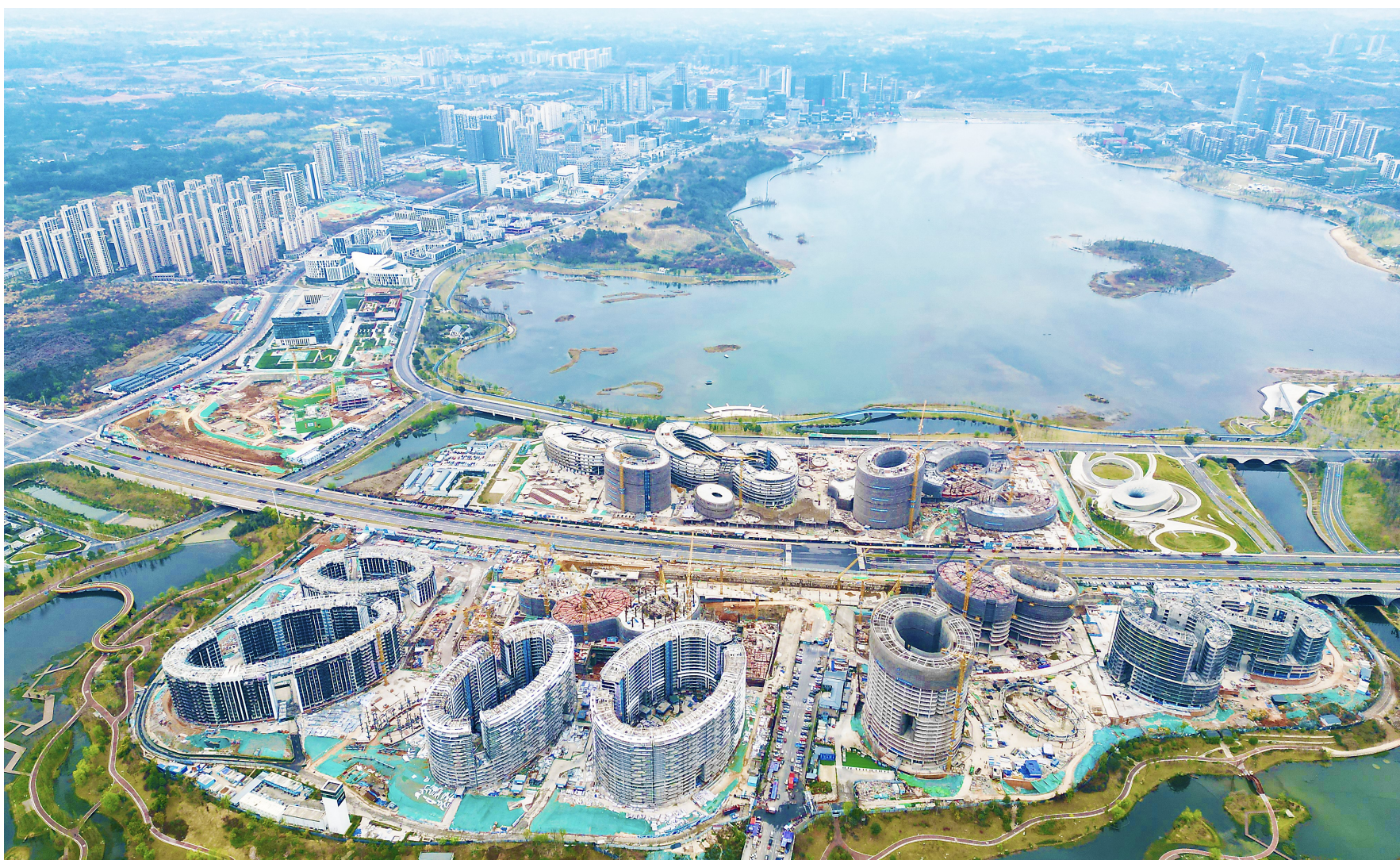
四川省成都市兴隆湖畔的天府新区独角兽岛园区由多个高度不同的圆弧形建筑构成,似一个个“圆形细胞体”有序排列,目前主体已基本建成。据悉,独角兽岛总建筑面积达140万平方米,建设目标为“全国首家千亿元级数字经济近零碳产业园区”。图为航拍兴隆湖畔的天府新区独角兽岛园区建设工地。 中新社记者 张 浪摄
