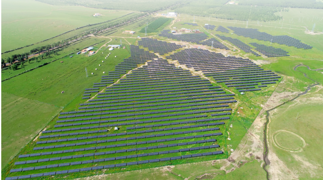
锡林郭勒盟太仆寺旗村级光伏扶贫电站。
