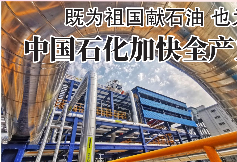
中国石化CCUS(碳捕获、利用与封存)项目齐鲁石化碳捕集环节装置。中国石化供图
