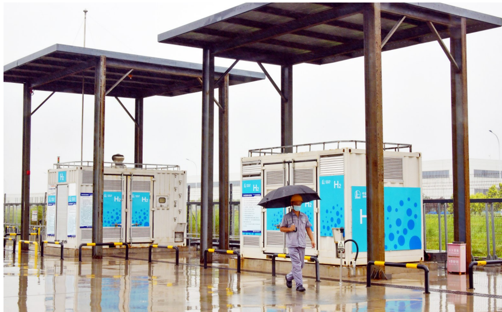
天津滨海新区临港经济区智能装备园内的加氢设施。章柯摄
