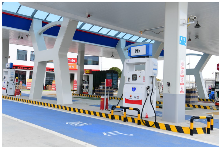
中国石油在上海地区建成首座油氢合建站——临港新片区平霄路油氢合建站。
