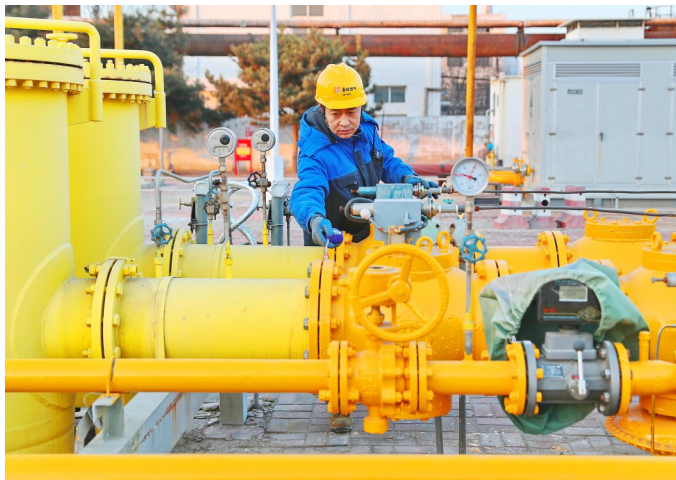
河北省秦皇岛市海港区的秦皇岛华润燃气有限公司的工人正在巡检燃气设施。 人民图片
