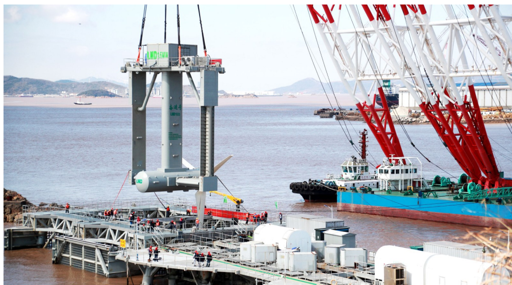
2月24日,一台单机重量达350吨、发电功率1.6兆瓦、完全由我国自主研发的第四代潮流能发电机组(奋进号)在浙江省舟山市岱山县秀山岛海域下海,LHD林栋海洋潮流能发电站再添新机组。中新社发 姚峰摄
