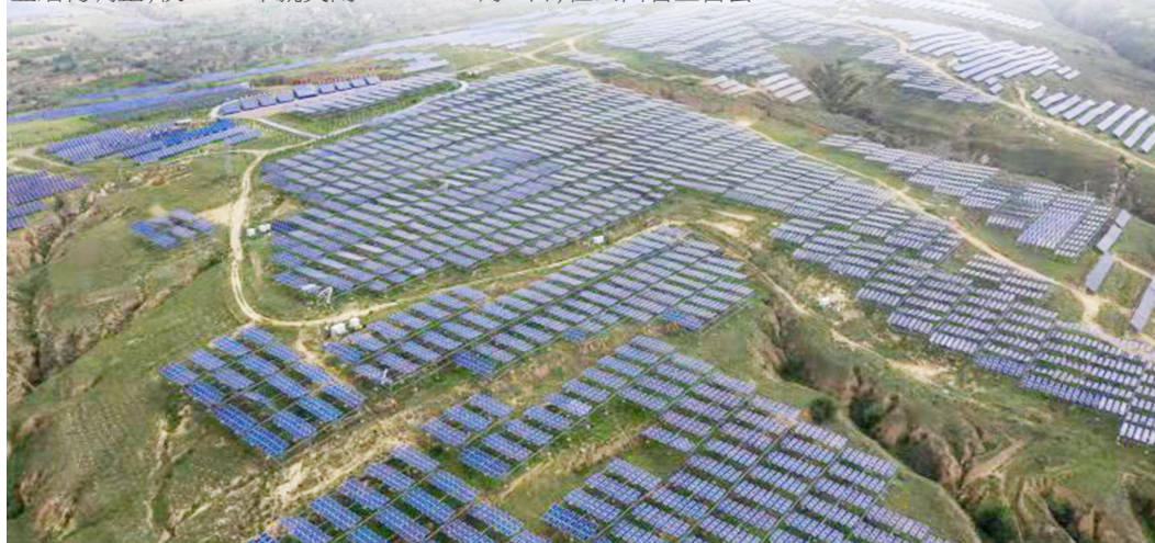
晋能控股电力集团左云光伏电站建于采煤深陷区，光伏发电设备鳞次栉比排列着，在阳光下熠熠生辉。
