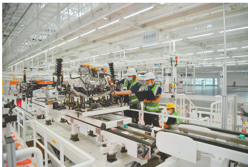
7月8日,在位于长春国际汽车城的一汽红旗新能源汽车工厂内,工作人员在进行设备调试。一汽红旗新能源汽车工厂于2020年4月开工,预计2021年12月竣工投产,目前处于生产线的装配与调试阶段,未来这里将主要生产红旗品牌新能源汽车,整车年产能将达到20万辆。 中新社记者 张 瑶 摄
