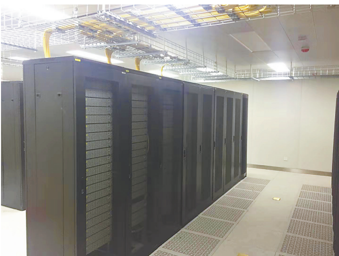
运营中的数据中心机房。
