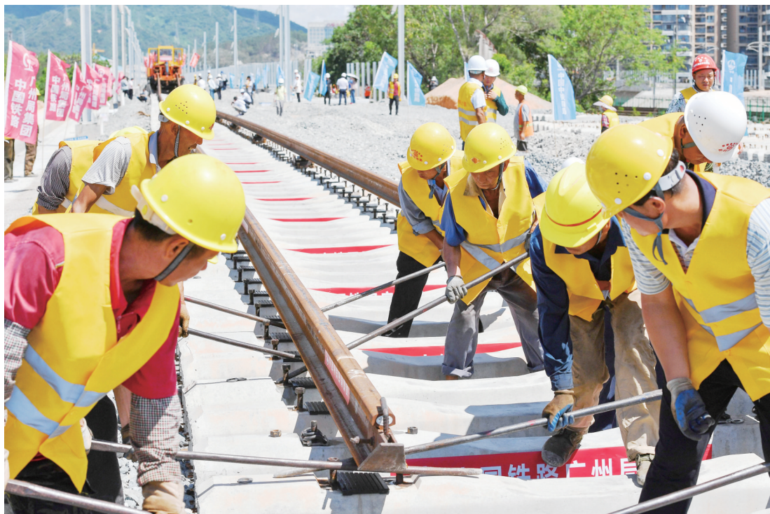
5月27日,中铁四局施工人员在深圳北站外铺设赣深铁路广东段南端大里程方向最后一对长轨。当日,随着中铁四局铺轨机组将一对长轨与深圳北站线路南段成功对接,赣深高铁广东段南端大里程方向正线铺轨全部完成。赣深高铁设计时速350公里,预计将于2021年年底通车,届时赣州和深圳两地的通行时间将由目前最快6个小时左右压缩至2个小时以内。
