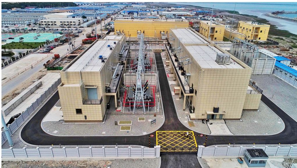
5月16日，位于浙江省舟山市北部海域的岱山4号海上风电场并网接入工程顺利投运，开始并网运行发电。海风“送来”的清洁能源，源源不断供给鱼山岛绿色石化基地。新华社记者 徐昱摄
