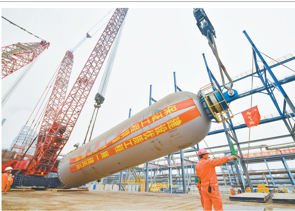
辽宁锦州石化：资源替代转型升级项目核心装置反应器吊装成功
