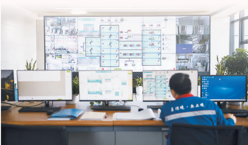
▲在四川省成都天府国际生物城再生水厂中控室，工作人员观察水厂系统运行情况。 新华社记者 胥冰洁摄
