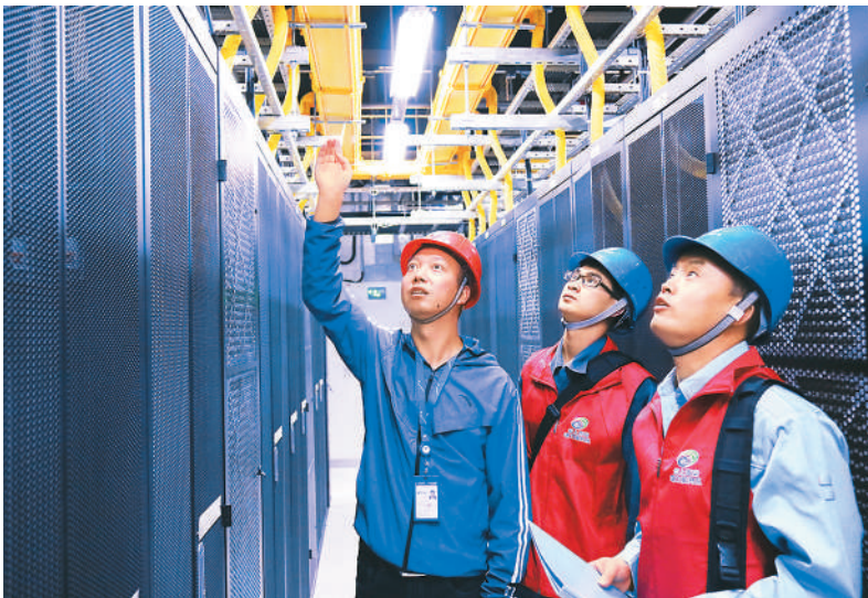
作为东数西算枢纽节点，贵州省贵安新区承接粤港澳大湾区大量离线计算、数据存储业务，供电运维人员坚守一线，保障算力电源持续可靠，以西部电力支撑大湾区数字经济。图为贵州电网公司贵安供电局工作人员在机房开展用电设备巡检运维。滕德云摄
