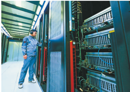
在位于内蒙古呼和浩特市和林格尔新区的内蒙古中科超算科技有限公司，工作人员巡检算力设备。
