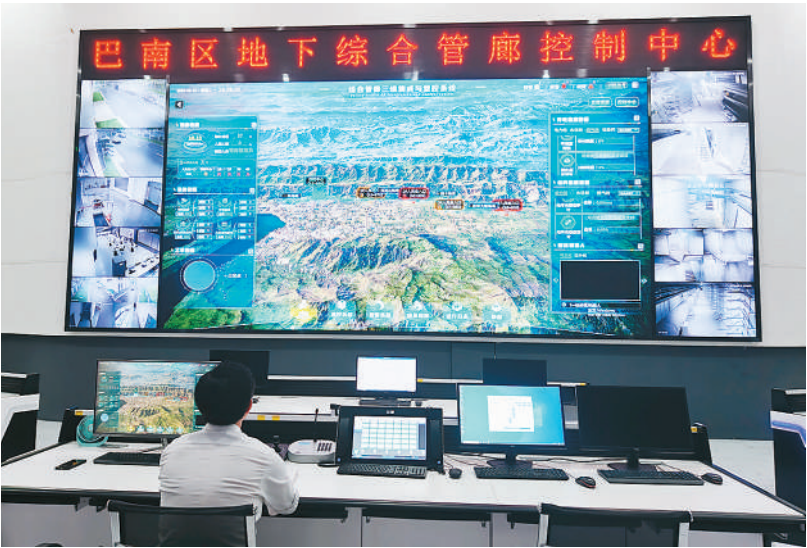
▲在重庆市巴南区地下综合管廊控制中心，工作人员通过综合管廊三维集成与管控系统查看巴南区龙洲湾片区地下综合管廊的环境、结构等监测数据。 新华社记者 郑世昌摄
