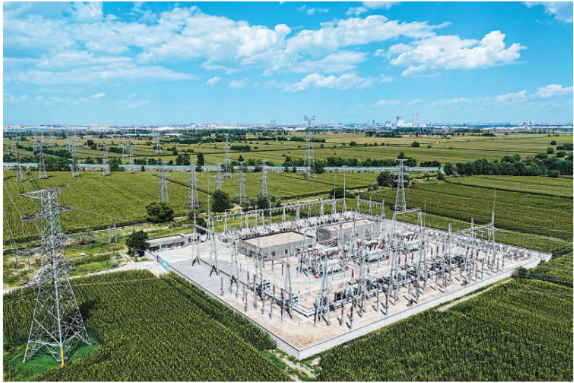
8月18日，位于宁夏银川市的一处输变电工程项目，银线铁塔在田野中架起一条条绿色能源通道。袁宏彦摄（人民图片）
