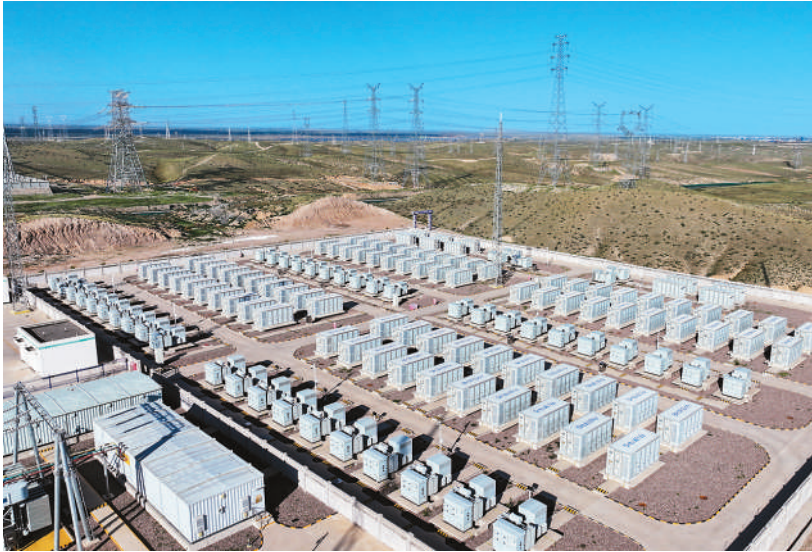
宁夏回族自治区银川市加快构建以新能源为主体的新型电力系统,不断助力夏季能源保供。图为当地的新型储能电站。
