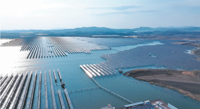
大连庄河市永记水库一期10万千瓦渔光互补光伏发电项目，年发电量超1.6亿千瓦时。
