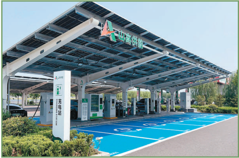
山东济南东服务区的充电站棚顶铺设了太阳能光伏板。受访者供图
