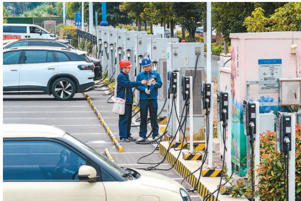
6月15日，在安徽省芜湖市南陵县籍山镇来邦广场充电站，国网南陵县供电公司工作人员在对充电桩进行巡检。 肖本祥摄（人民图片）
