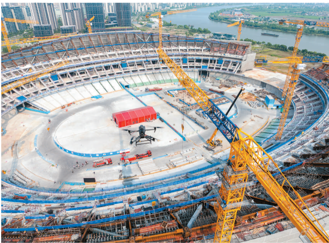
近日，浙江省宁波奥体中心二期工程施工现场如火如荼，一块块预制清水看台板被精准吊装至预定位置，各项工作紧张有序。图为智能巡检无人机在施工区域进行自动巡查。
