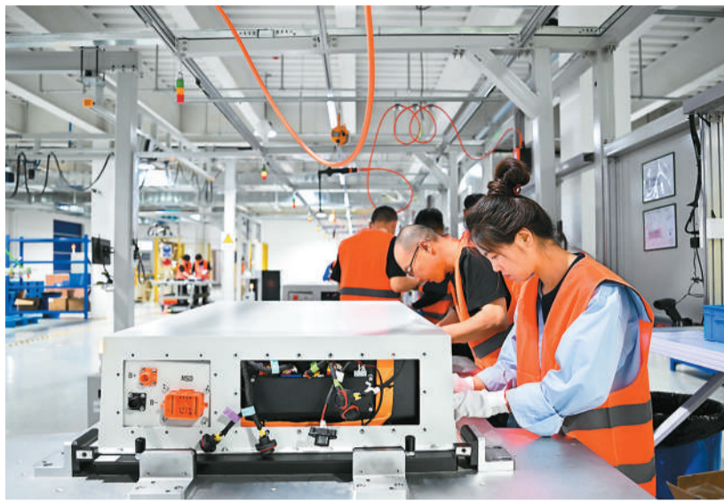
5月21日，在位于天津市静海区的一家新能源科技公司储能系统集成总装工厂，工作人员装配电池包。新华社记者 赵子硕摄
