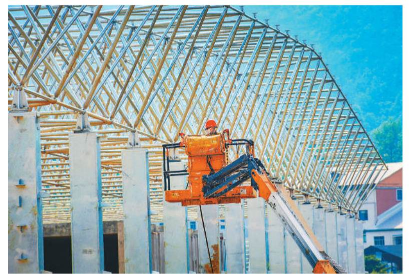
安徽省安庆市岳西县加快推进农业产业项目建设，着力打造集生产、加工、服务等于一体的现代农业平台，推动农业生产提质增效。图为5月12日，工人在岳西县一处现代农业产业基地项目现场施工。 吴均奇摄（人民视觉）
