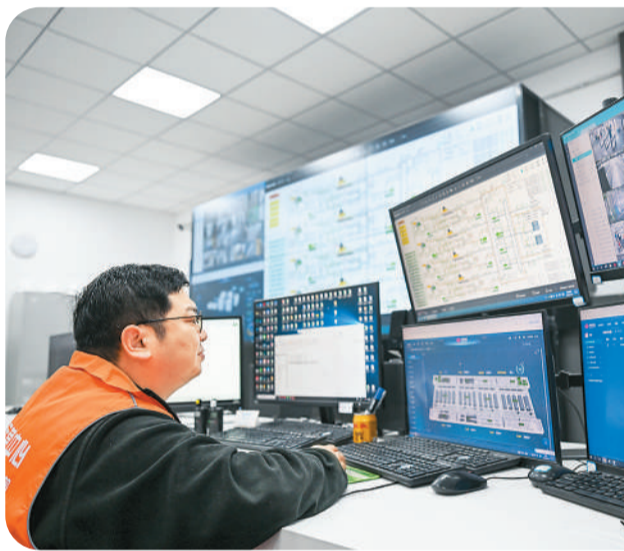
地处京津冀三地交汇处的天津产业新城高村数智创新中心，目前已建成投用6个高水平数据中心，具有较高的算力服务水平。图为在位于该园区的中国联通京津冀数字科技产业园，工程师监测服务器设施运行情况。 新华社记者 孙凡越摄
