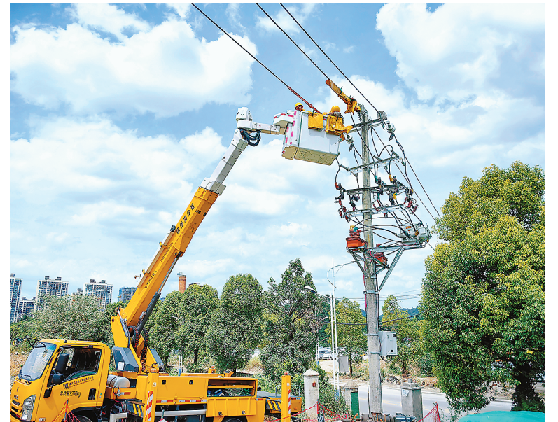
近日，在贵州省遵义市播州区龙坑街道，南方电网贵州遵义播州供电局带电作业人员完成10千伏桂龙IV回和10千伏忠瑞线的智能化自动开关搭接投运。今年以来，遵义播州供电局大力推进新型电力系统项目建设，有效提升配网线路智能化水平，推动电网向智能高效型转变，为居民提供安全可靠电力保障。陈琪摄（人民视觉）
