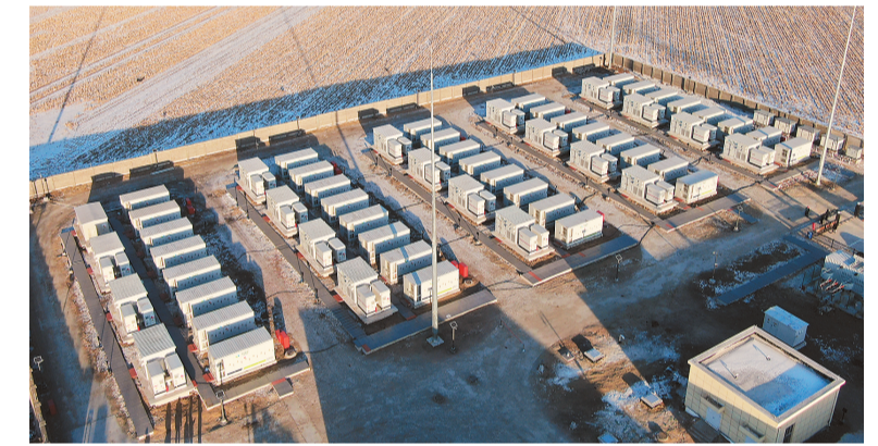
在国网长春供电公司积极推进建设下，吉林长春五棵松220千伏变电站内的磷酸铁锂储能电站项目日前顺利并网投运，该站是吉林省首批采用磷酸铁锂电池储能项目，电站储能容量为20万千瓦时，仅用两小时即可完成蓄能充电，满蓄状态可满足近3万户居民用户全天用电。
