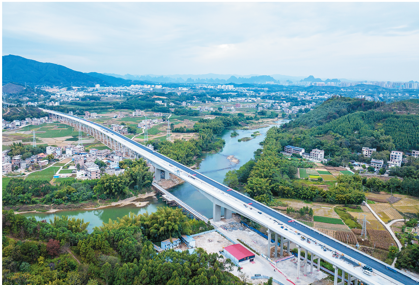
近日，广东清远连山至广西贺州高速公路贺江特大桥项目正在加紧建设。贺江特大桥全长1246.4米，是连贺高速公路项目重点控制性工程。该高速公路项目计划于今年底建成通车，目前全线进入施工全面冲刺阶段。该项目建成后将进一步完善广西高速公路网络，对推动粤桂两省区之间的交通互联互通起到重要作用，有利于推动沿线经济社会发展。图为项目建设现场。
