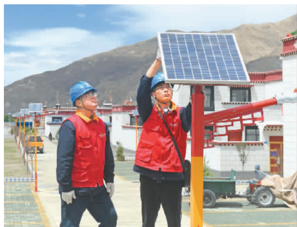
6月23日，在西藏自治区山南市琼结县下乡措杰村赞巴组易地搬迁安置点，国网安徽省电力有限公司援藏党员服务队队员正在为从海拔4300米扶贫搬迁下来的群众调试电网，确保易地搬迁群众生产生活用电无忧。(人民视觉)
