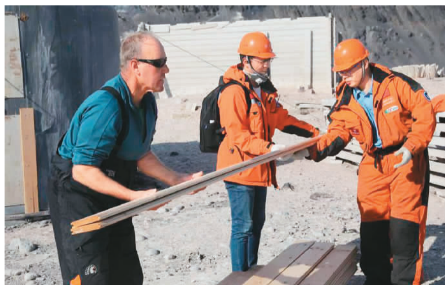
中国考察队员协助新西兰同行开展南极阿代尔角历史文化遗产修复施工。新华社发
