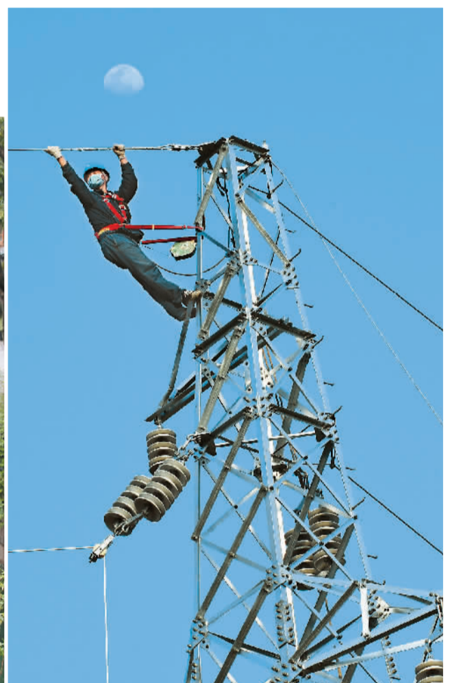
▲ 在安徽省亳州市谯城区双沟变电所至古城镇龙德35KV输电线路施工现场，电力工人正在架设输电线路。 张延林摄（人民视觉）
