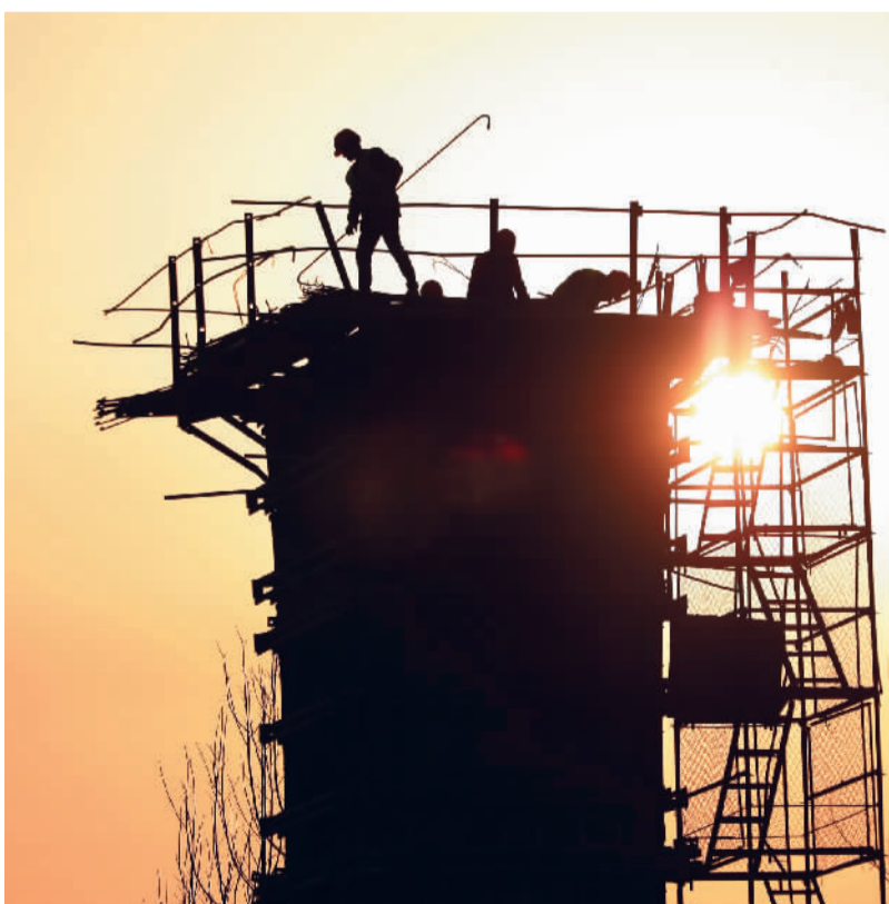
▲ 在浙江省台州市域铁路S1线温岭段工地，工人正在施工。 周学军摄（人民视觉）
