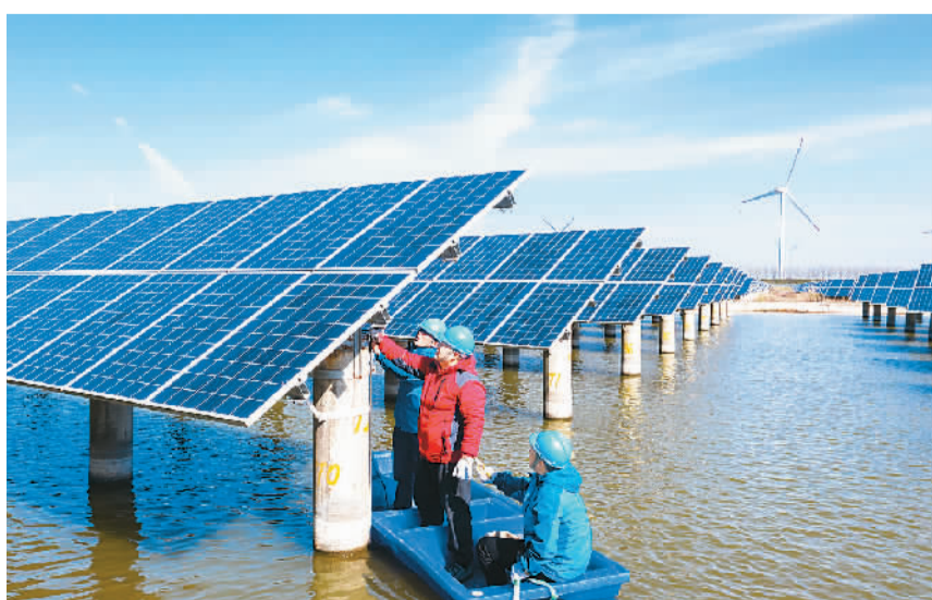
江苏省海安市滨海新区在沿海开发中，一方面注重湿地保护，一方面运用广阔的滩涂资源培育壮大太阳能、风能等新能源产业，在有效实现节能减排的同时，推动地方经济绿色发展。图为4月5日，海安市海东光伏电站工作人员正在检查光伏发电设施。 翟慧勇摄（人民视觉）
