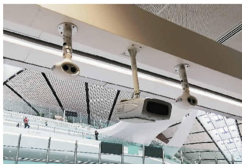
智能检验检疫 位于智能检验检疫台上方的两台红外测温仪和一台放射性物质定位检测仪
