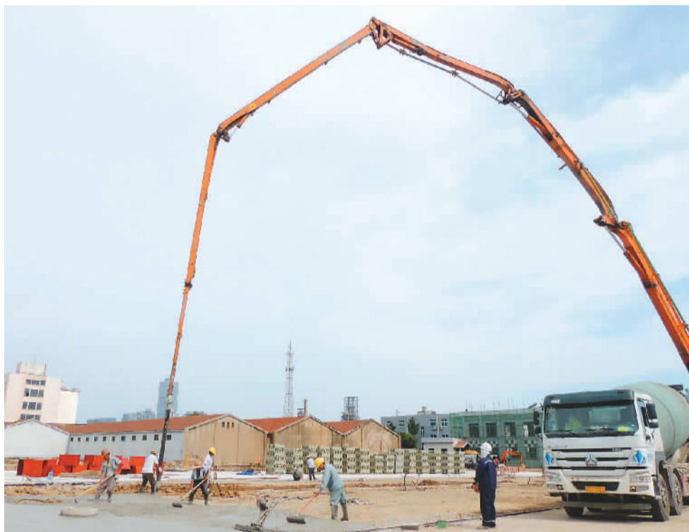
江苏省连云港市市郊铁路目前正在建设之中，是该省首条市郊铁路，线路全长35.1公里。图为近日工人在连云港市市郊铁路墟沟站前广场施工。 耿玉和摄（人民视觉）
