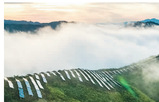
近年来,湖北省十堰市竹溪县荒山为清洁能源经济发展优势,大力推进有效利用荒山弃地建设光伏发电基地,促进绿色经济快速发展。图为竹溪县新洲镇新发村光伏发电基地一角。
