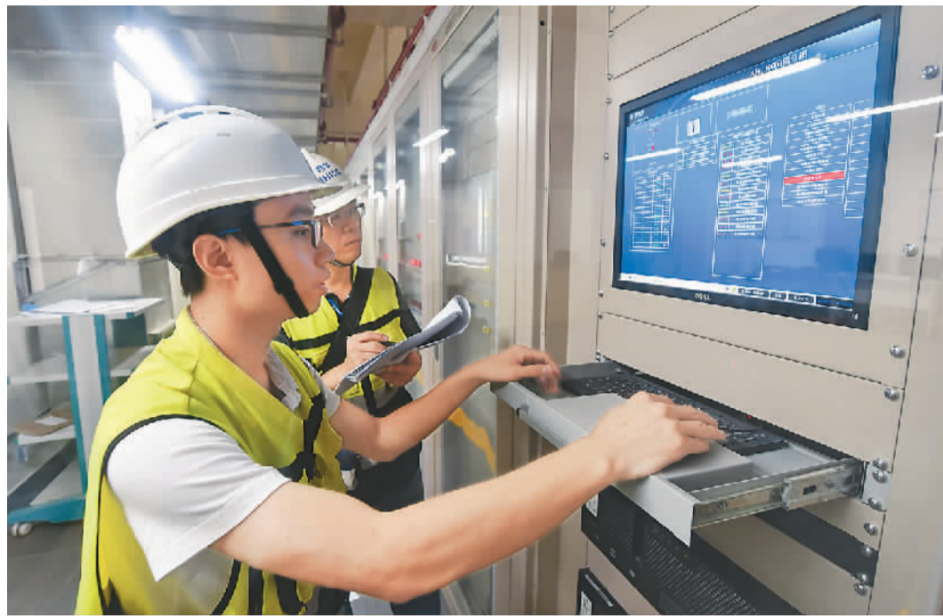
福建晋华存储器集成电路生产线项目的技术人员在调试低压侧二十千伏出线智能变电站的“四通”设备。新华社记者 宋为伟摄
