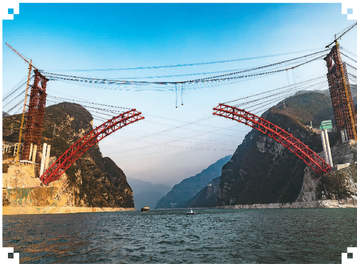
3月8日，三峡库区湖北省秭归县香溪长江公路大桥建设进展顺利，大桥主拱钢箱桁架合龙在即。图为建设中的香溪长江公路大桥。 郑家裕摄（人民视觉）
