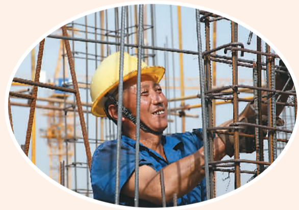
▲ 国庆节前夕,中国铁建二十二局四公司承担的叶巴滩水电站排沙洞河排水洞、天津宝坻房建等工地一片忙碌景象,工人们节假日期间将坚守岗位。图为职工在施工。武新才 武蓝摄影报道
