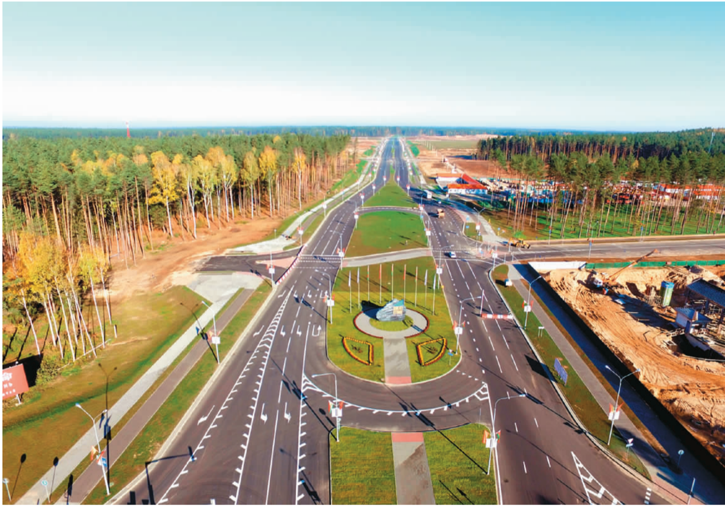
在白俄罗斯首都明斯克以东25公里处的一片旷野中，一个以“巨石”命名的工业园正在建设中。这就是总面积将达91.5平方公里的中白工业园，是中国企业在全球范围参与建设的最大海外工业园区，也是中白合作共建“丝绸之路经济带”的标志性工程。新华社发
