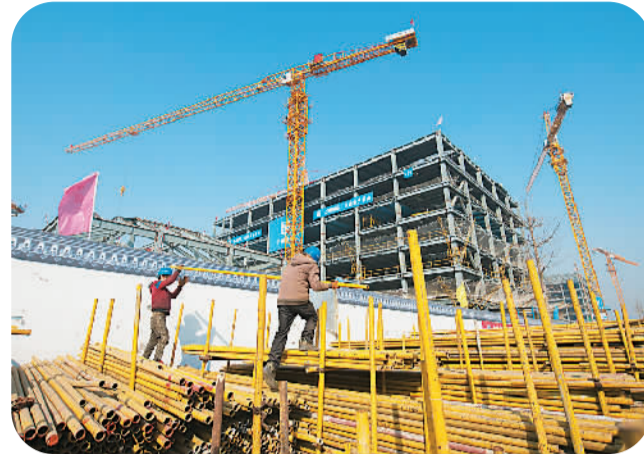
图为工人在北京城市副中心建设工地施工。 罗晓光摄（新华社发）
