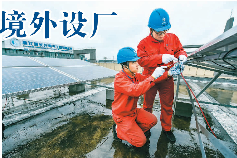
浙江省长兴县湖州昆仑电气设备有限公司工作人员检查分布式光伏电站设备运行情况。新华社记者 徐昱摄
