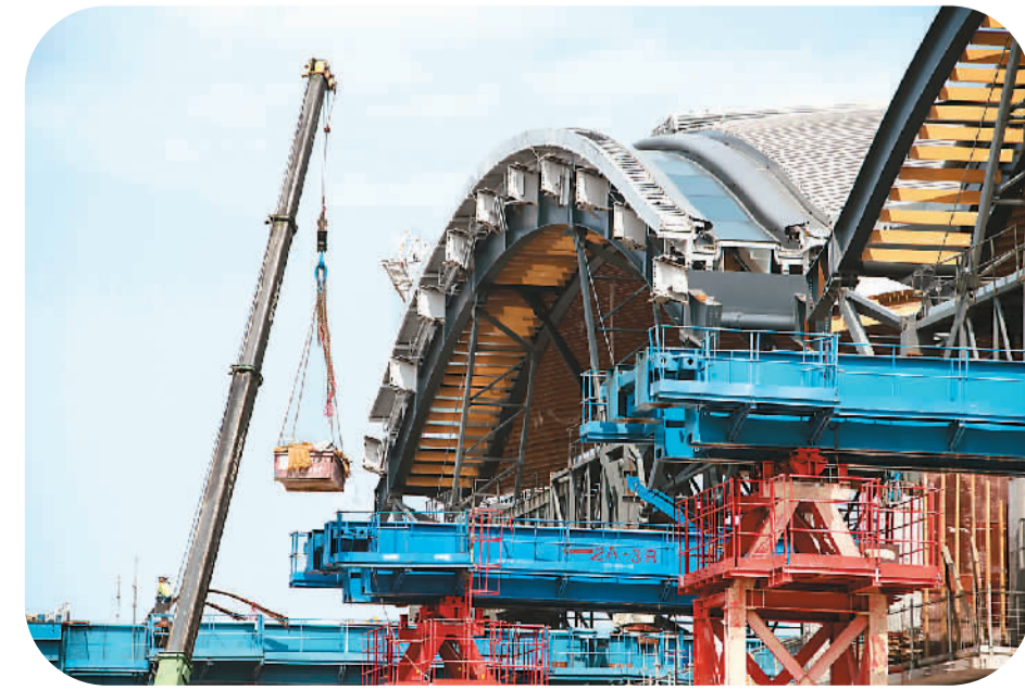
图为二月九日，工人在港珠澳大桥香港口岸工地工作。新华社记者 吕小焯摄
