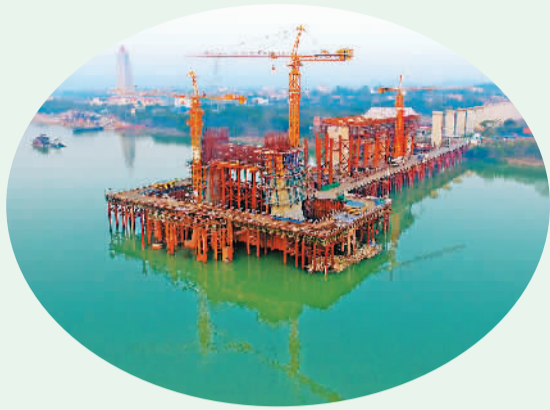
2016年12月17日,国家重点建设项目——昌赣客专赣州赣江特大桥进入主塔下横梁浇筑阶段,主塔雏形初现,为全线2019年底建成通车奠定了基础。昌赣高铁设计时速350公里。 陈地长摄(人民视觉)
